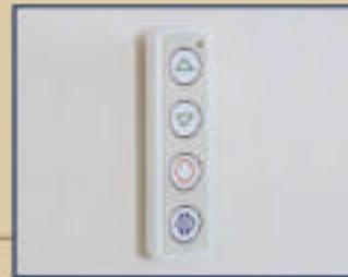
trådløs påkallingsstasjon ved etasjene
